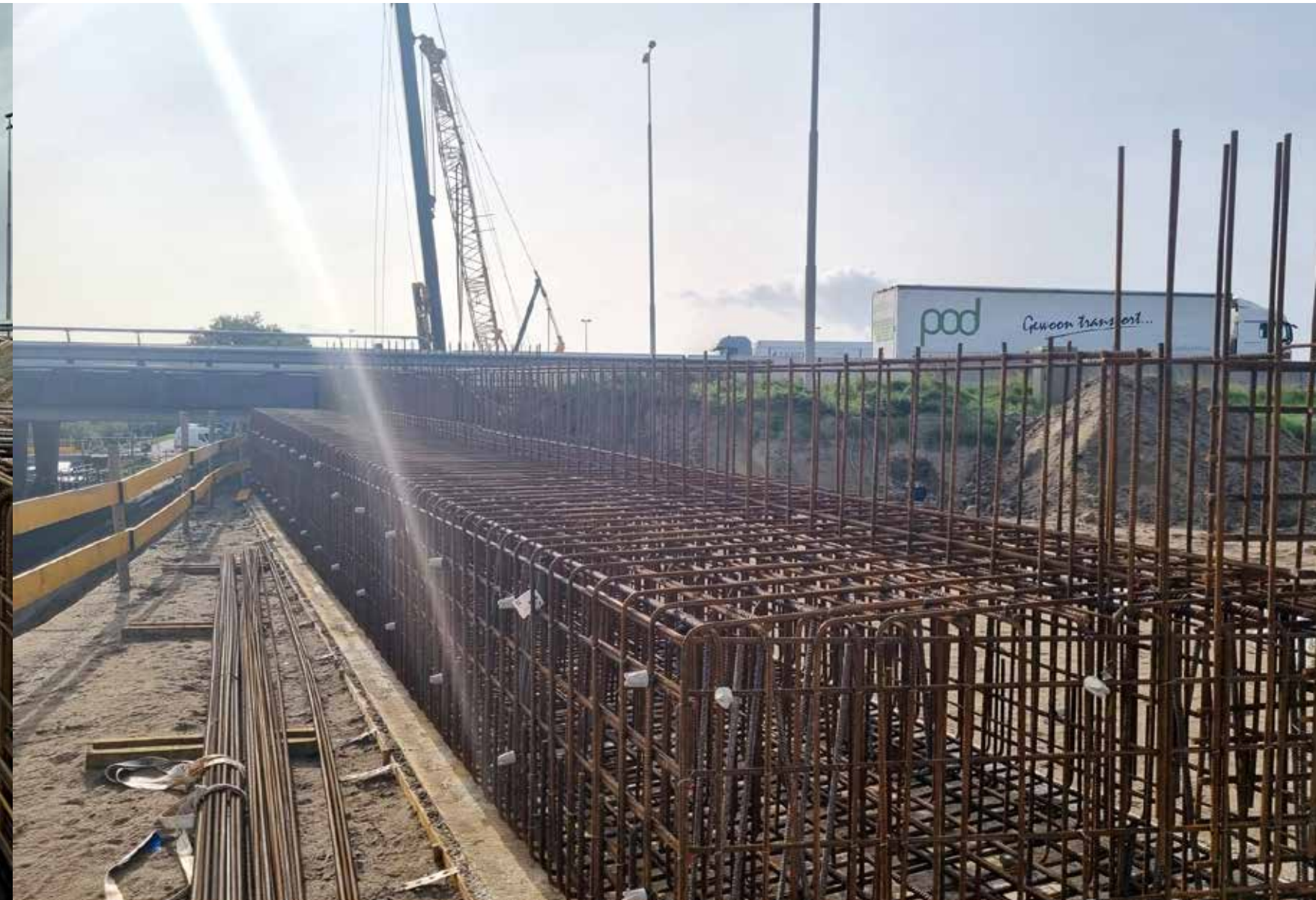
Voor het A1-project levert Holterman het wapeningsstaal in verschillende diameters van \varnothing 8 tot \varnothing 40 mm.
